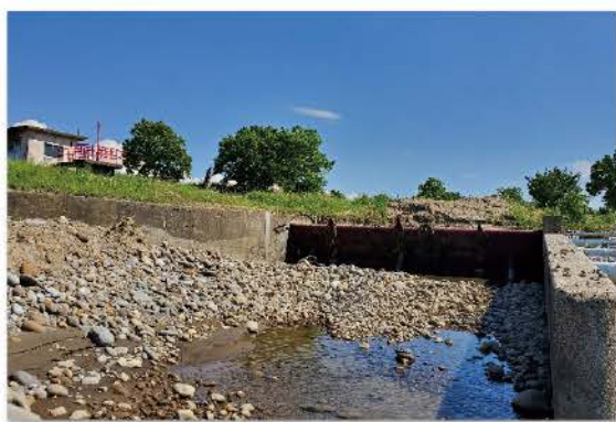
今年度より改修工事が始まる柳井田頭首工 (妙高市柳井田内地内 矢代川)
