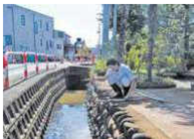
▲改修を待つ大和三ヶ字用水路 (上越妙高駅前)
